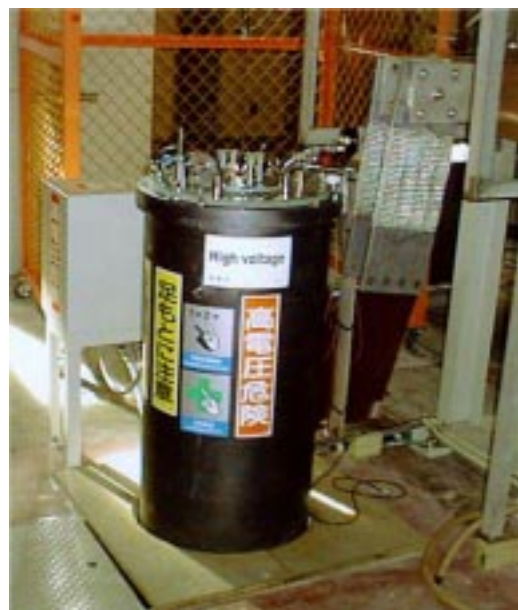
図2 . 1.2MVA 交流超電導マグネット
