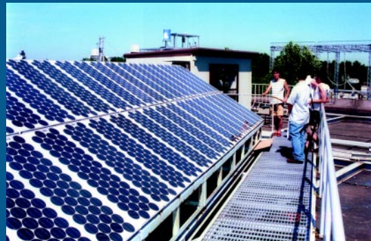
太陽光発電システム
