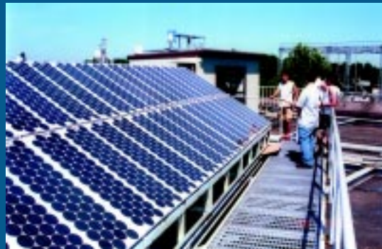
太陽光発電システム
