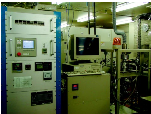
写真1 大容量型高純度オゾン発生装置 (左より) 制御盤、オゾンナイザ、液化部
