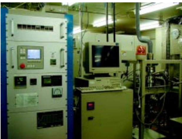
写真1 大容量型高純度オゾン発生装置 (左より) 制御盤、オゾンナイザ、液化部
